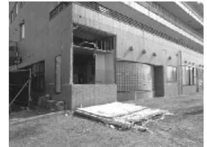
風呂場の壁が倒れた状況
